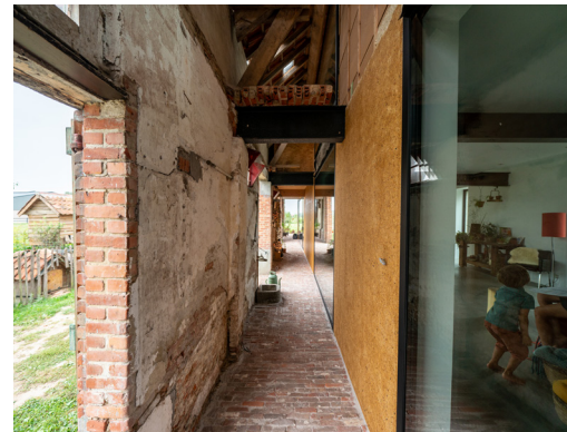
Bij renovaties wordt het box-in-box principe wel eens gebruikt om het bestaande gebouw en de nieuwe invulling fysiek te scheiden. © Jasper Leonard, RANT Architecten bv
